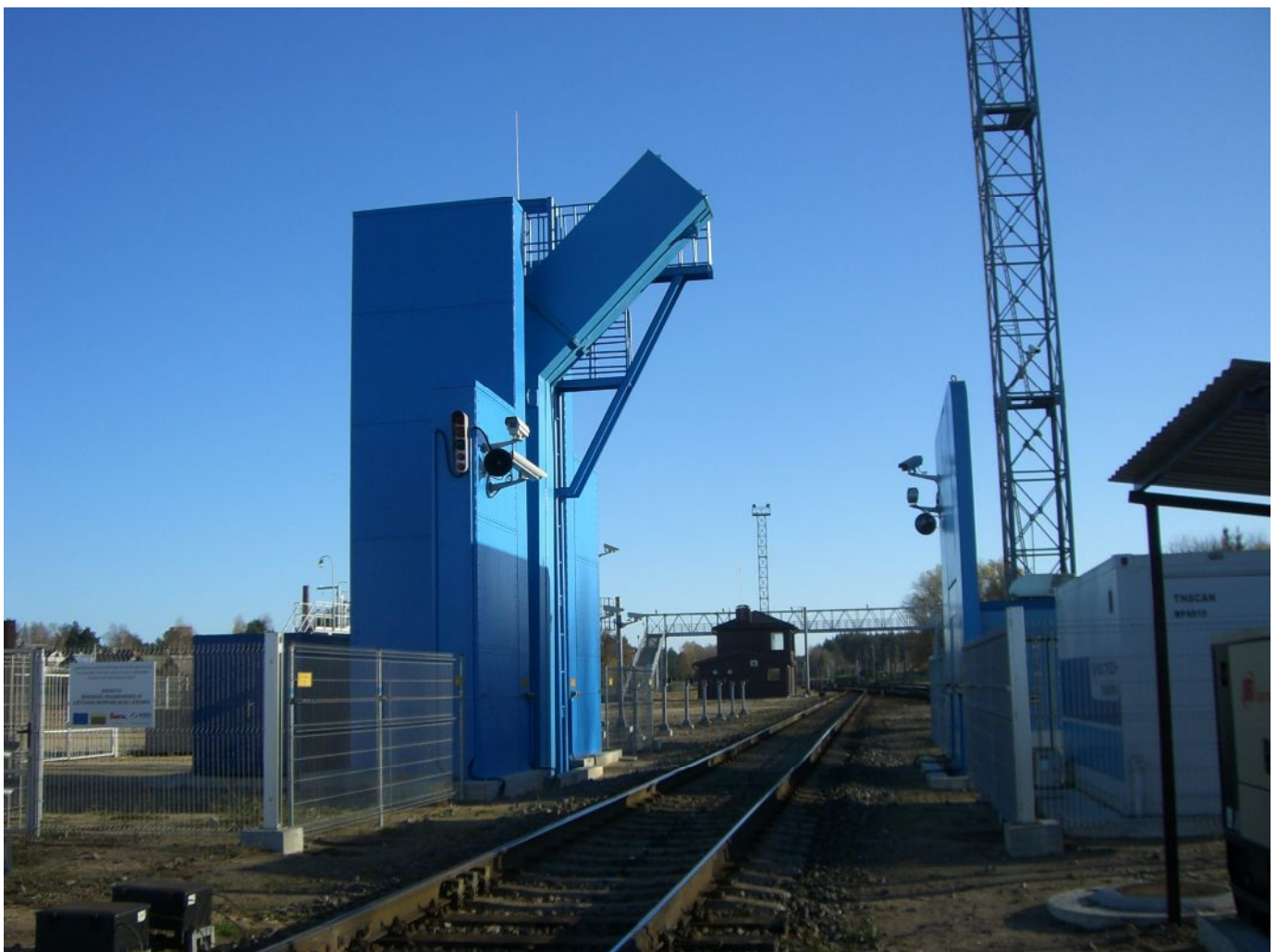
Nuotraukoje - Kenos geležinkelio pasienio kontrolės punkte įrengta jonizuojančios spinduliuotės sistema
